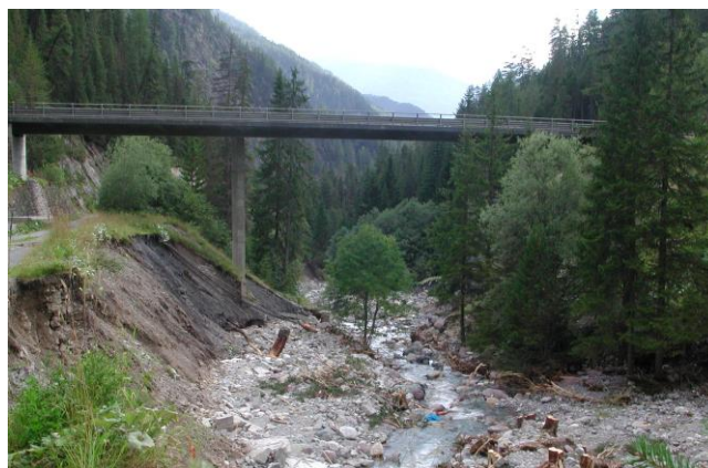
Verwüstetes Bachbett, freigelegter Pfeiler
