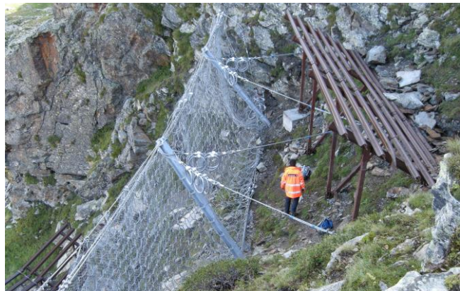
Steinschlagschutznetz RXI-300 unterhalb Werk 1
